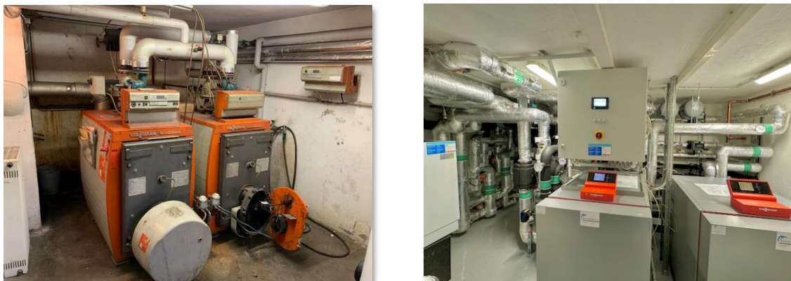
Abbildung 2: links: Heizraum vor der Umrüstung / rechts: nach der Umrüstung
